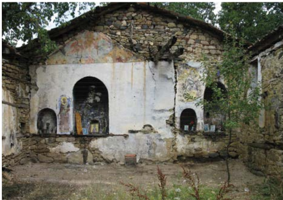
Сн. 22. Полуразрушената църква „Св. Николай“ в Бобошица – август 2009 г.
